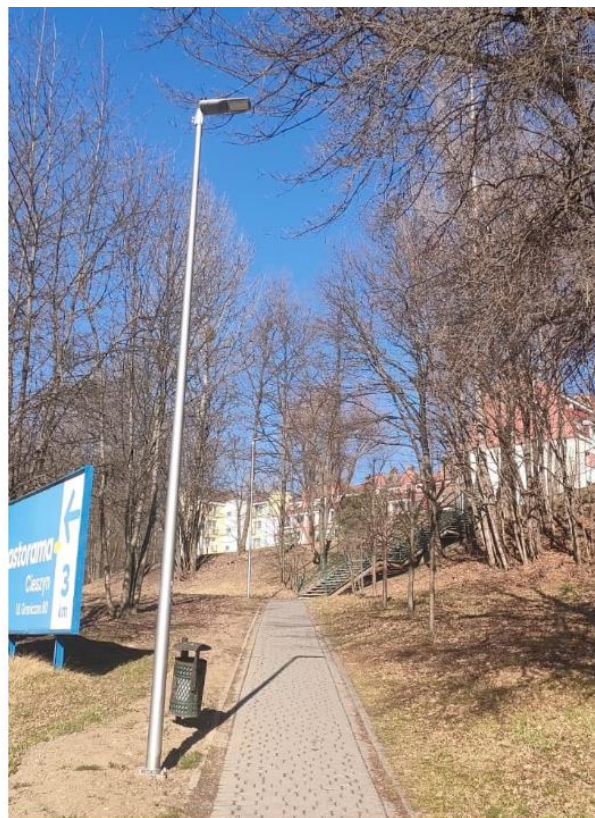
Rozbudowa oświetlenia publicznego – fot. ul. Hławiczki
