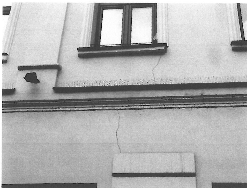
Rys. 11. Przykładowe zarysowania na elewacji (26.08.2021)
