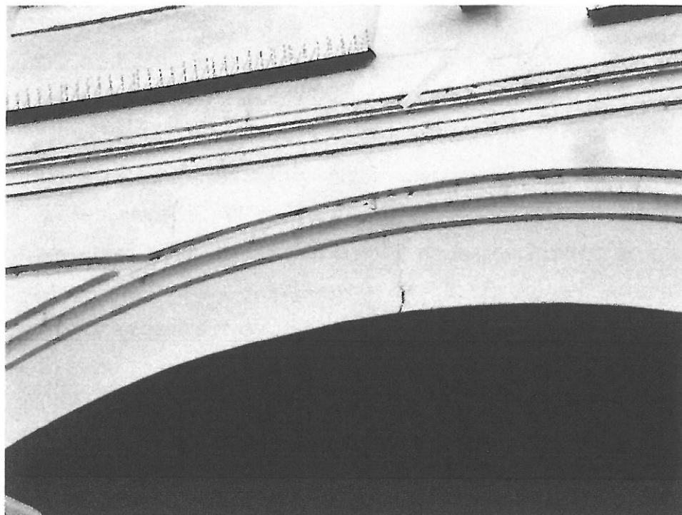
Rys. 12. Przykładowe zarysowania na łukach arkad (26.08.2021)
