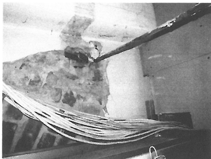
Rys. 20. Niejednorodna struktura muru parteru na słabej zaprawie wapiennej pod ukośnym pęknięciem ściany piętra – plomba nr 2.
