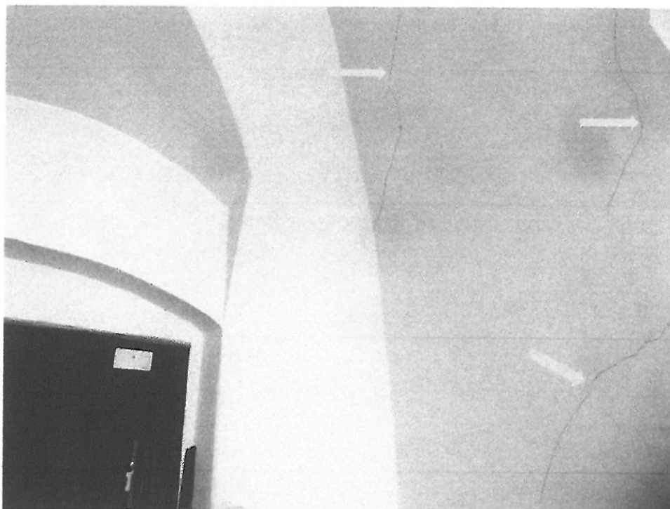
Rys. 10. Przykładowe zarysowania na sklepieniach (26.08.2021)
